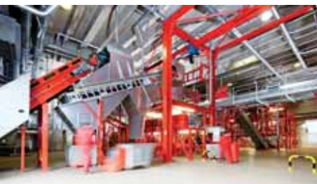
Neu. Die Granulieranlage.
