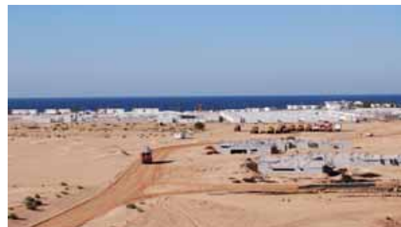
Malerisch. Die malerisch gelegene Zufahrt zu dieser Baustelle, im Hintergrund das Camp unseres Kunden mit 5.000 Bewohnern.
